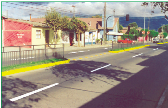
Vallas impiden cruce riesgoso de peatones. Se mantiene apertura para carros de Bomberos, pero se instalan tachones para desincentivar otros vehículos
