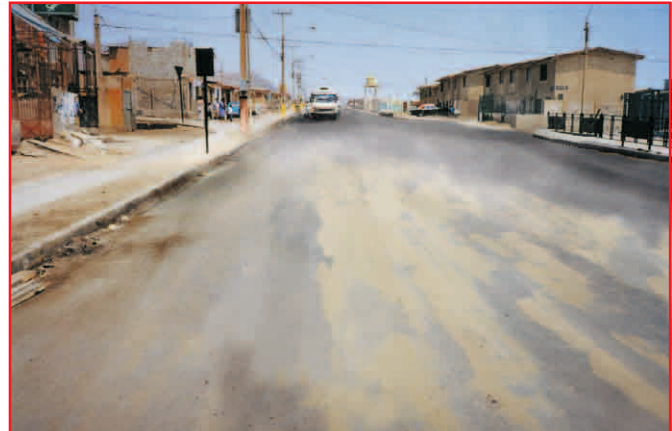
Vía larga recta y ancha incentiva la velocidad. No existen facilidades para el cruce de peatones, especialmente frente a los colegios
