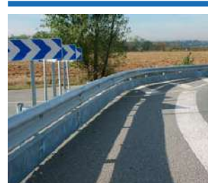
Barrera de contención en Francia
